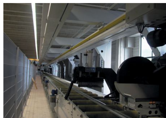
Strangpresse und Auslauf im Erdgeschoss (photo: H+H)
