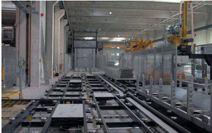
Obergeschoss: Blick vom Entstapler zu den Auslagerungsöfen
