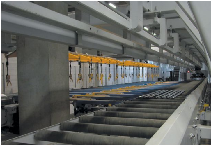
Profilstapler im Erdgeschoss
