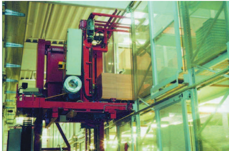
Umsetzer mit Verteilerwagen im Kommissionierlager bei Nobilia
