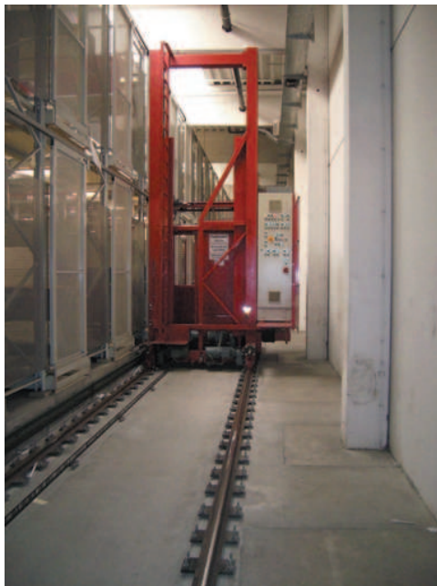
Regalbediengerät Nr. 3 vor dem Lager bei Nobilia Shelf-server unit No. 3 in front of the store at Nobilia
