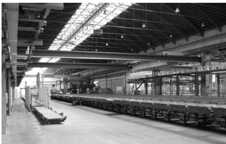
Automatikkran (über die gesamte Hallenbreite) vor den Wärmebehandlungsöfen, mit Sicherheitskorb (Bilder: H + H)
