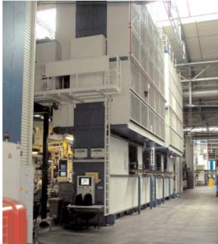
Speicherwechsellurm: Blick auf die Beladeseite. Dieser gegenüber ist der Montagearbeitsplatz erkennbar.
